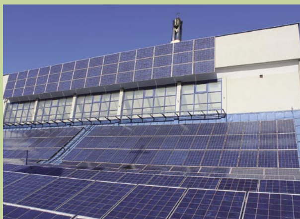
INSTALACJA SKŁADA SIĘ Z 312 MODUŁÓW FOTOWOLTAICZNYCH
