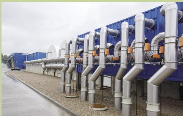
FRAGMENT NOWEJ INSTALACJI EKOLOGICZNEJ PRZY UL. MIŁOWICKIEJ W KATOWICACH
